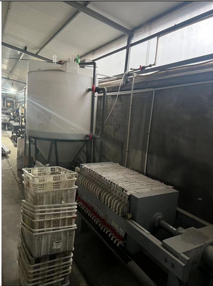
废水处理设施
