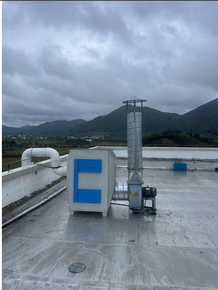
注塑废气活性炭处理
