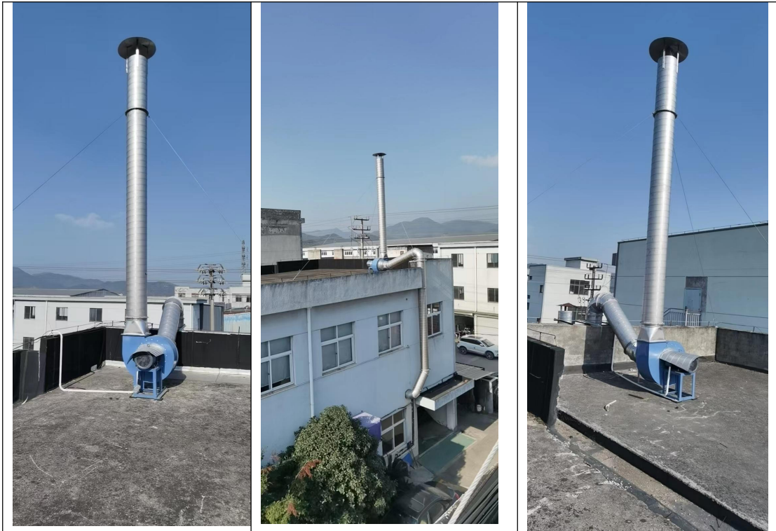
注塑废气排气筒
