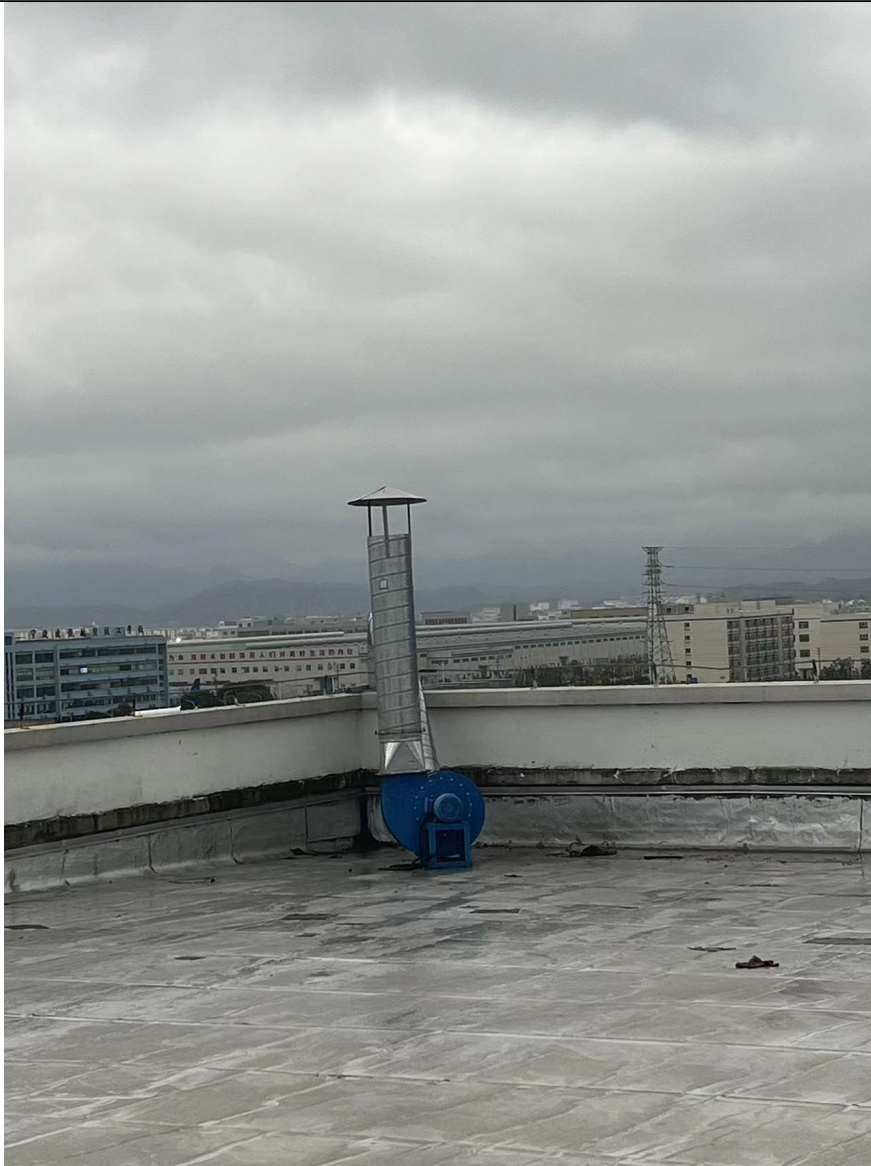
注塑废气排放
