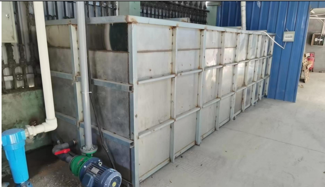
厂区污水处理站
