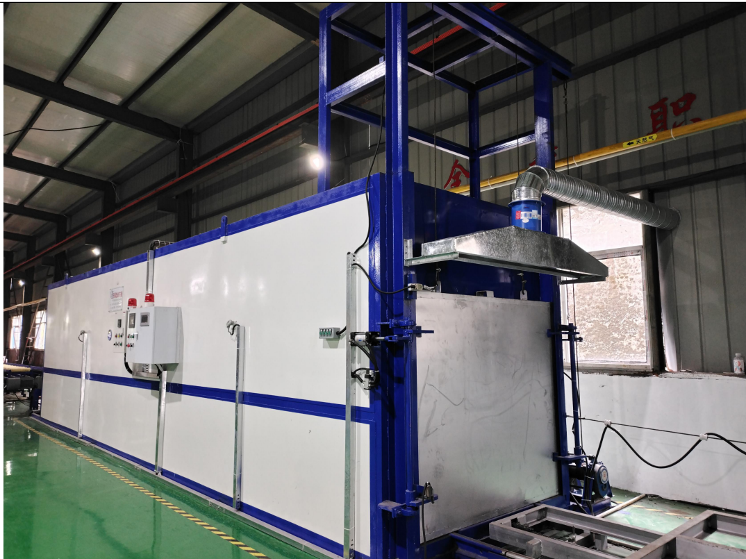
时效炉天然气燃烧废气通过管道排放
