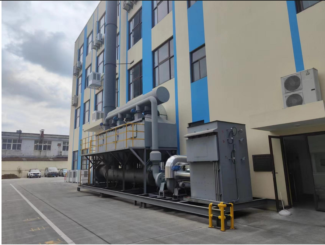
活性炭吸附-脱附+催化燃烧装置
