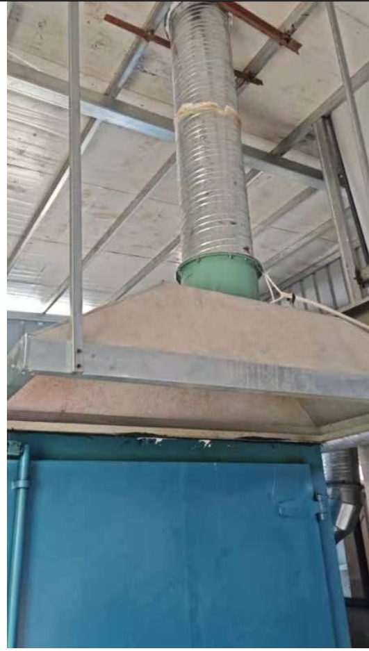
固化废气收集排放
