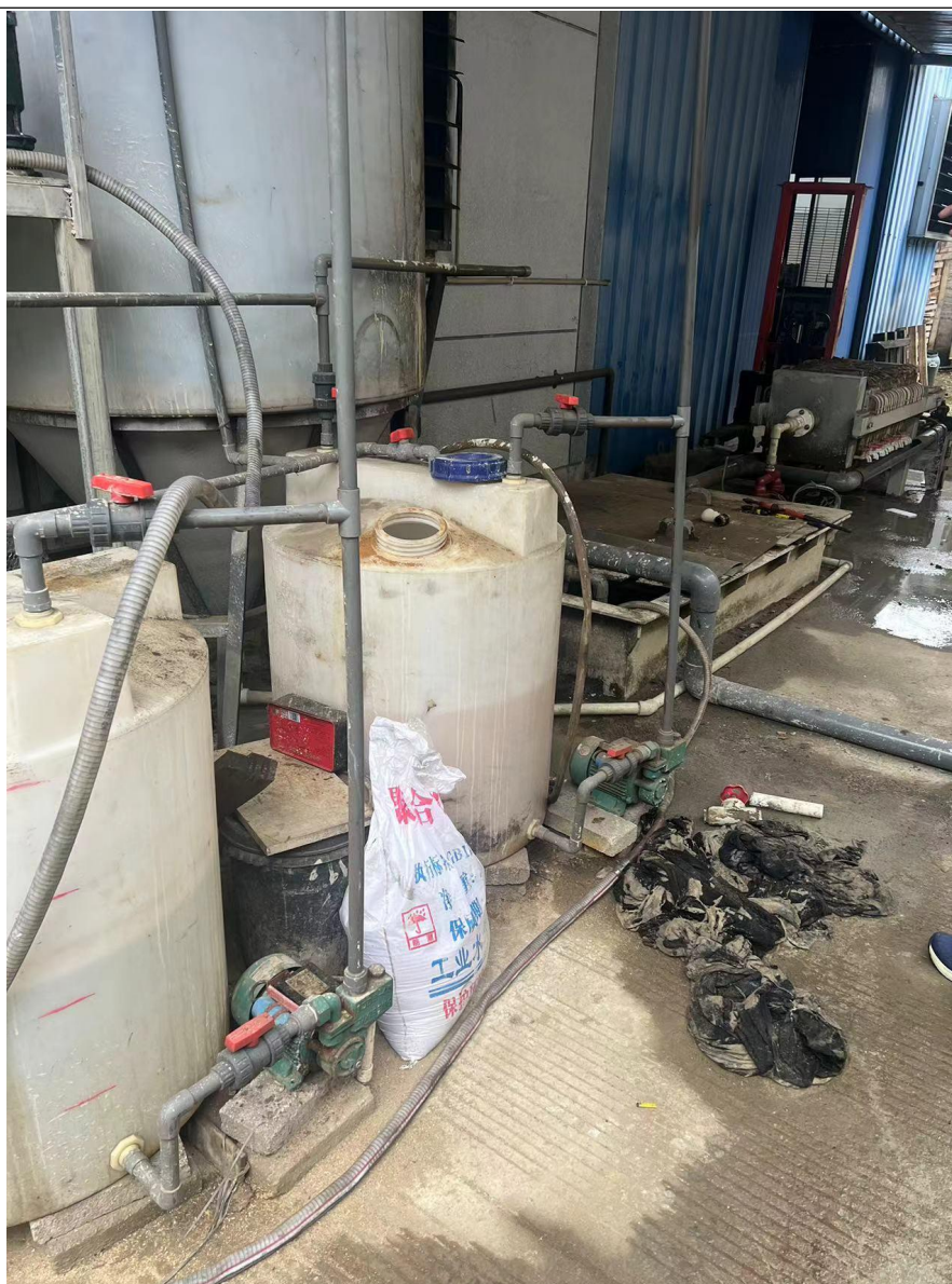
污水处理设施
