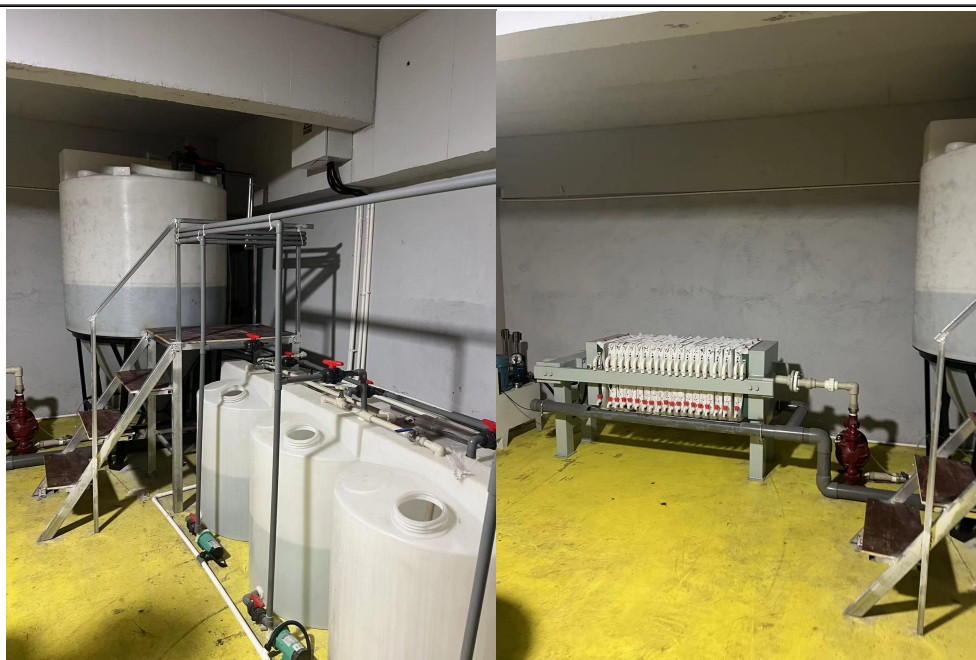
污水处理设施
