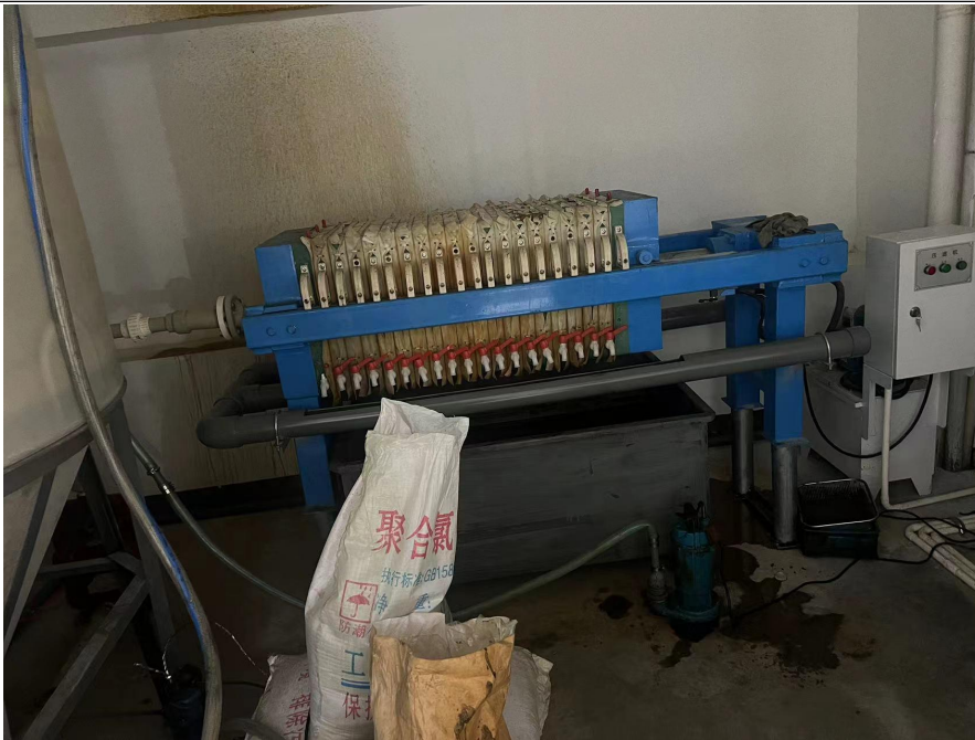
污水处理设施
