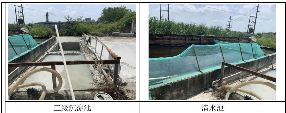
图5-3 项目废水治理设施
