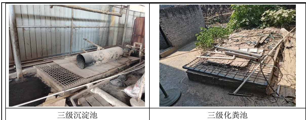
图5-3 项目废水治理设施
