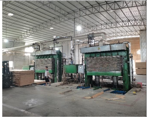
2#生产车间热压废气集气罩+收集管
