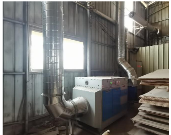
2#生产车间UV光催化氧化+活性炭吸附装置
