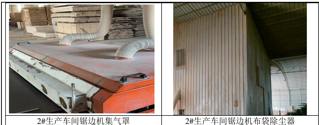
图5-1 废气治理设施
