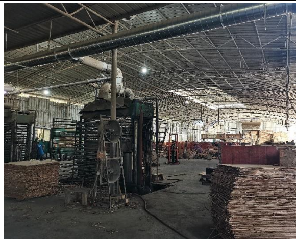
1#生产车间热压废气集气罩+收集管
