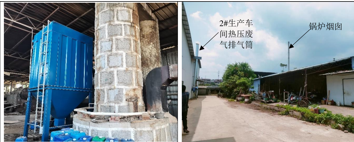
锅炉除尘设施：麻石水膜+布袋除尘器
