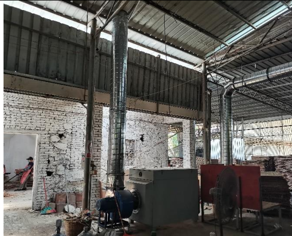
1#生产车间UV光催化氧化+活性炭吸附装置
