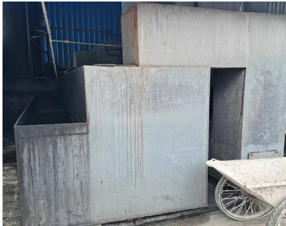
水浴除尘设施
