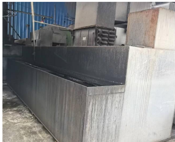
水浴除尘设施
