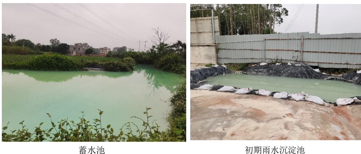
图5-3 废水治理设施
