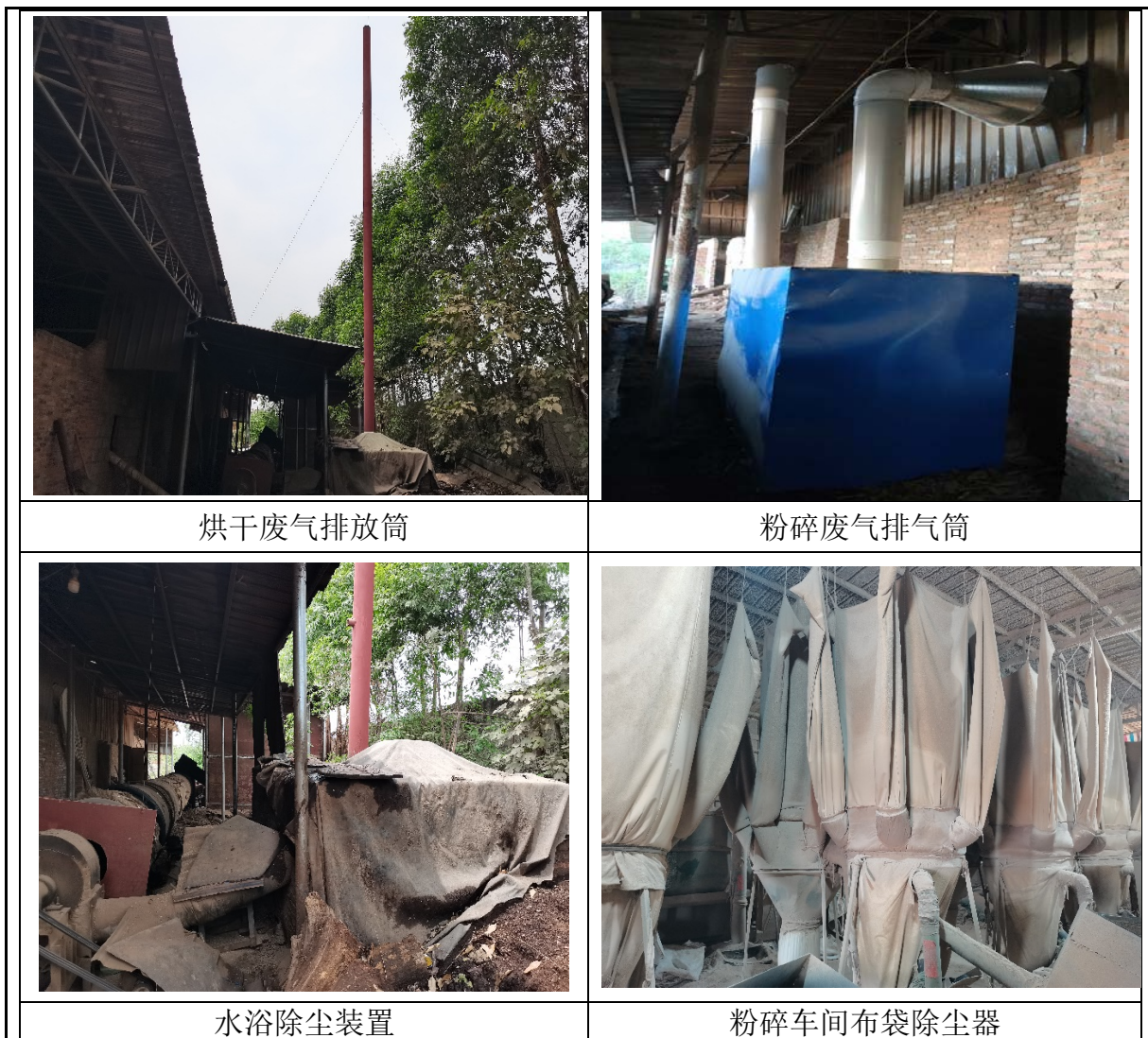
图5-3 废气治理设施
