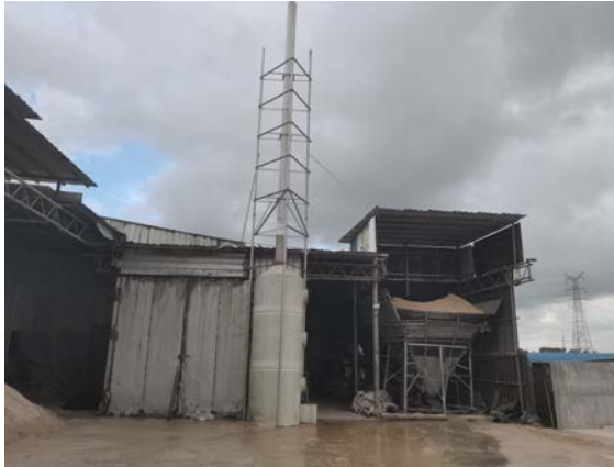
沉降室+喷淋塔
