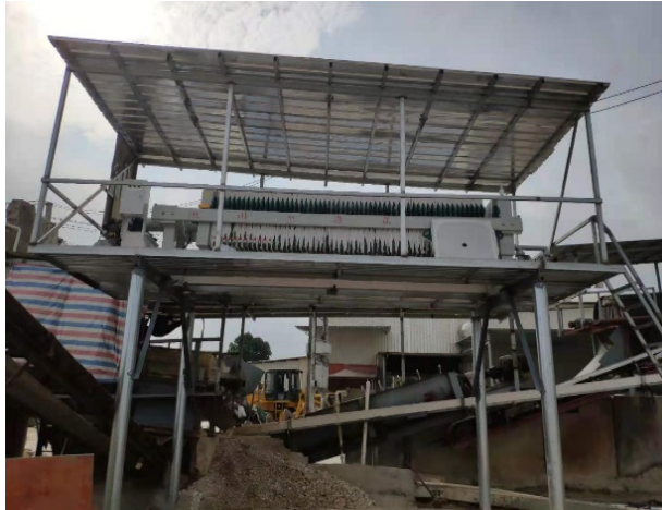
压滤机及污泥堆放区
