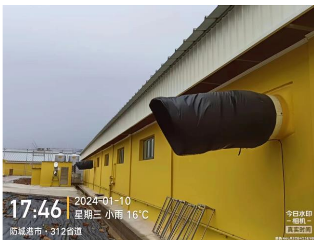
除臭剂喷洒设施
