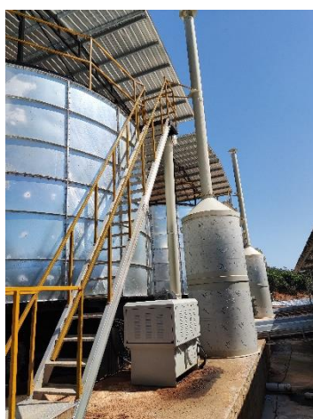
发酵废气喷淋塔
