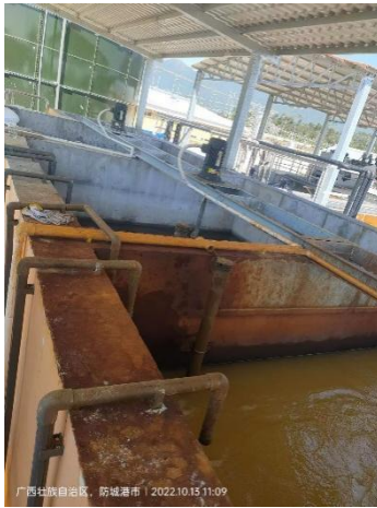
污水处理站加药池
