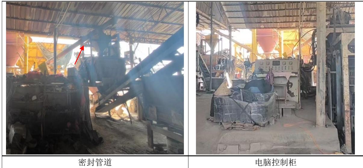
图5-1废气治理设施
