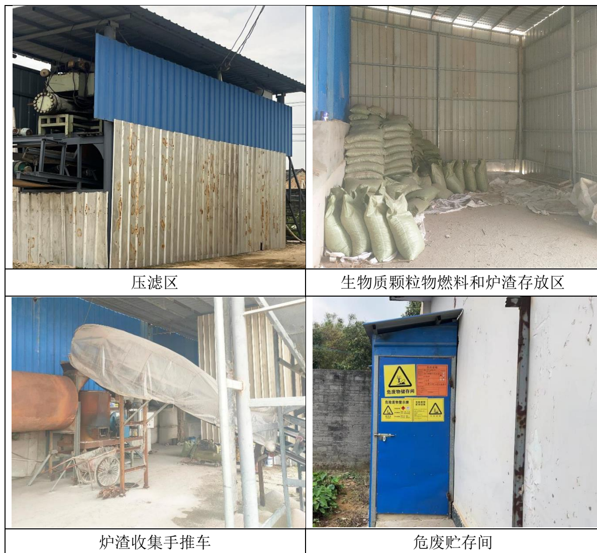
图5-4 项目固废治理设施
