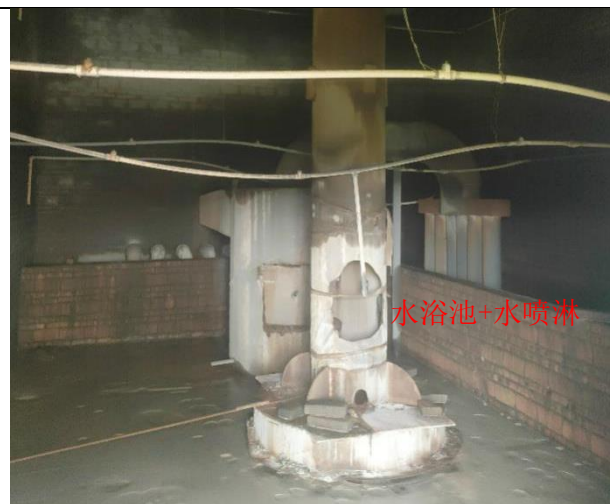
喷淋沉降室内部（水浴+喷淋）
