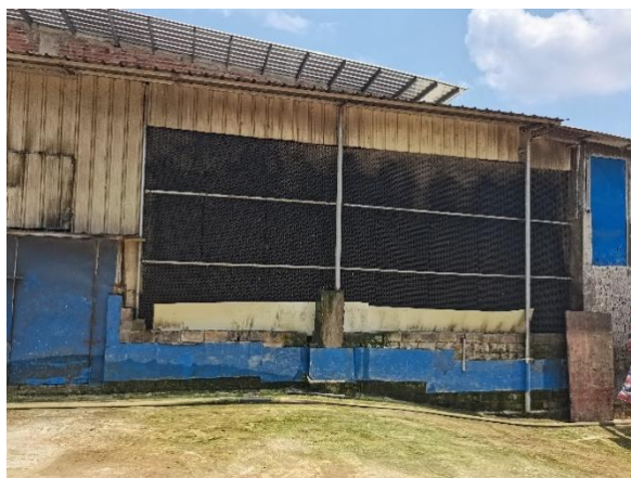
水帘降温除臭设施
