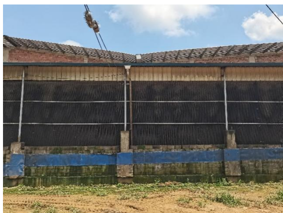
水帘降温除臭设施
