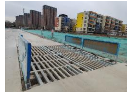
洗车沉淀池 (2021年12月)
