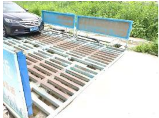
洗车沉淀池 (2021年6月)
