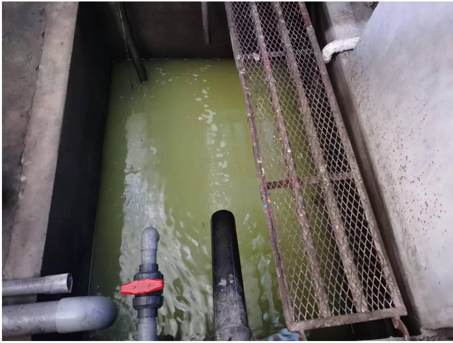
综合污水收集池
