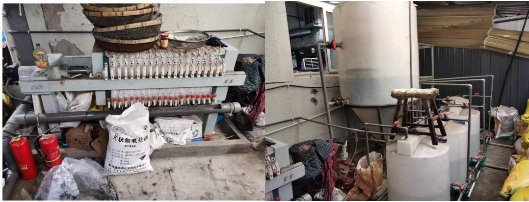
污水处理设施
