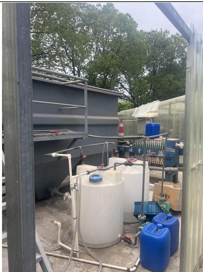
污水处理设施
