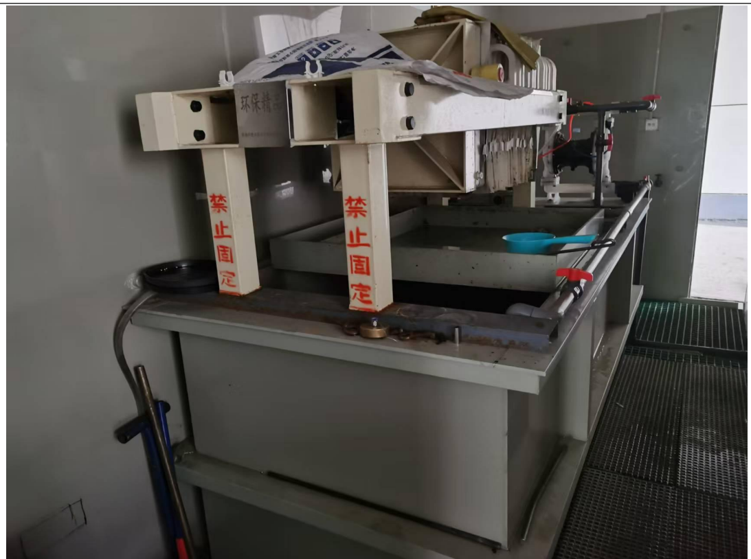
污水处理设施
