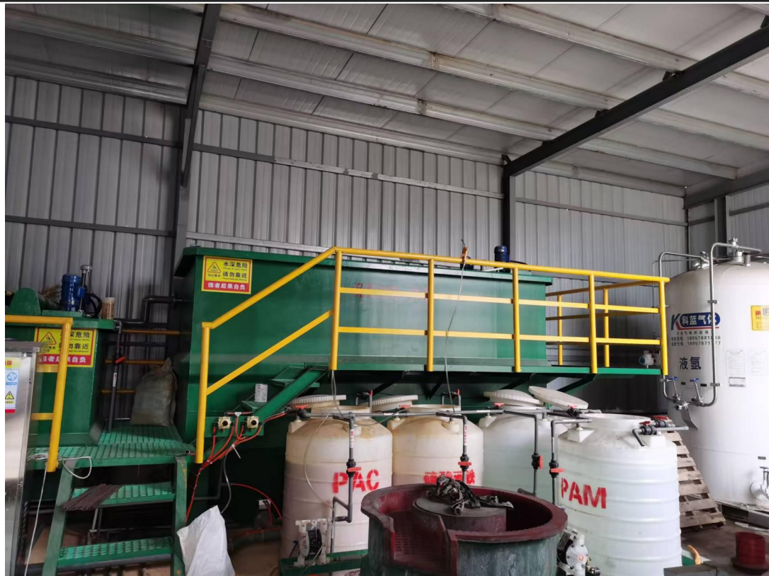
厂区污水处理站
