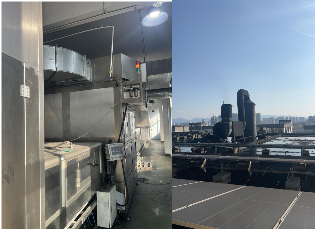
喷漆流水线、废气处理设施水喷淋+除湿+活性炭
