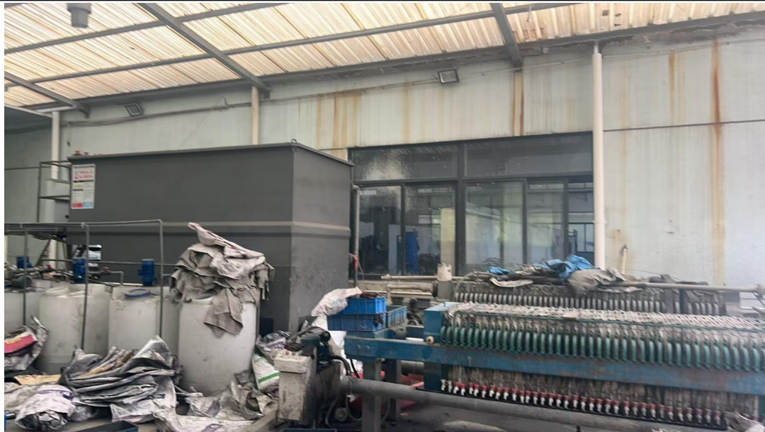
污水处理设施
