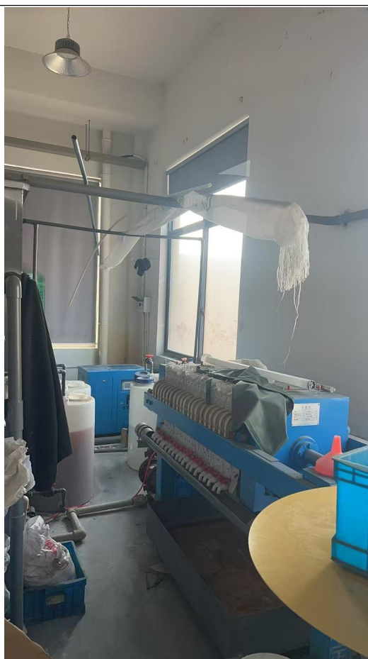
厂区污水处理站
