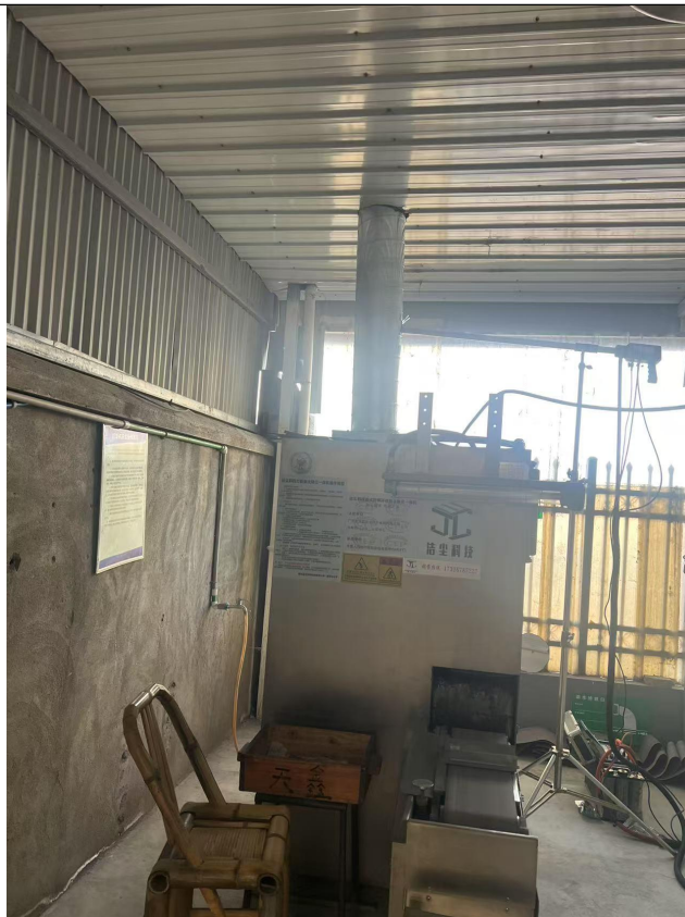
抛光机配套的水柜水帘装置
