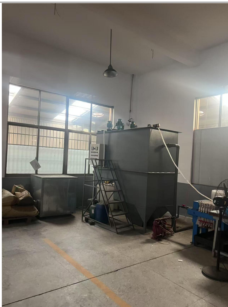
污水处理设施
