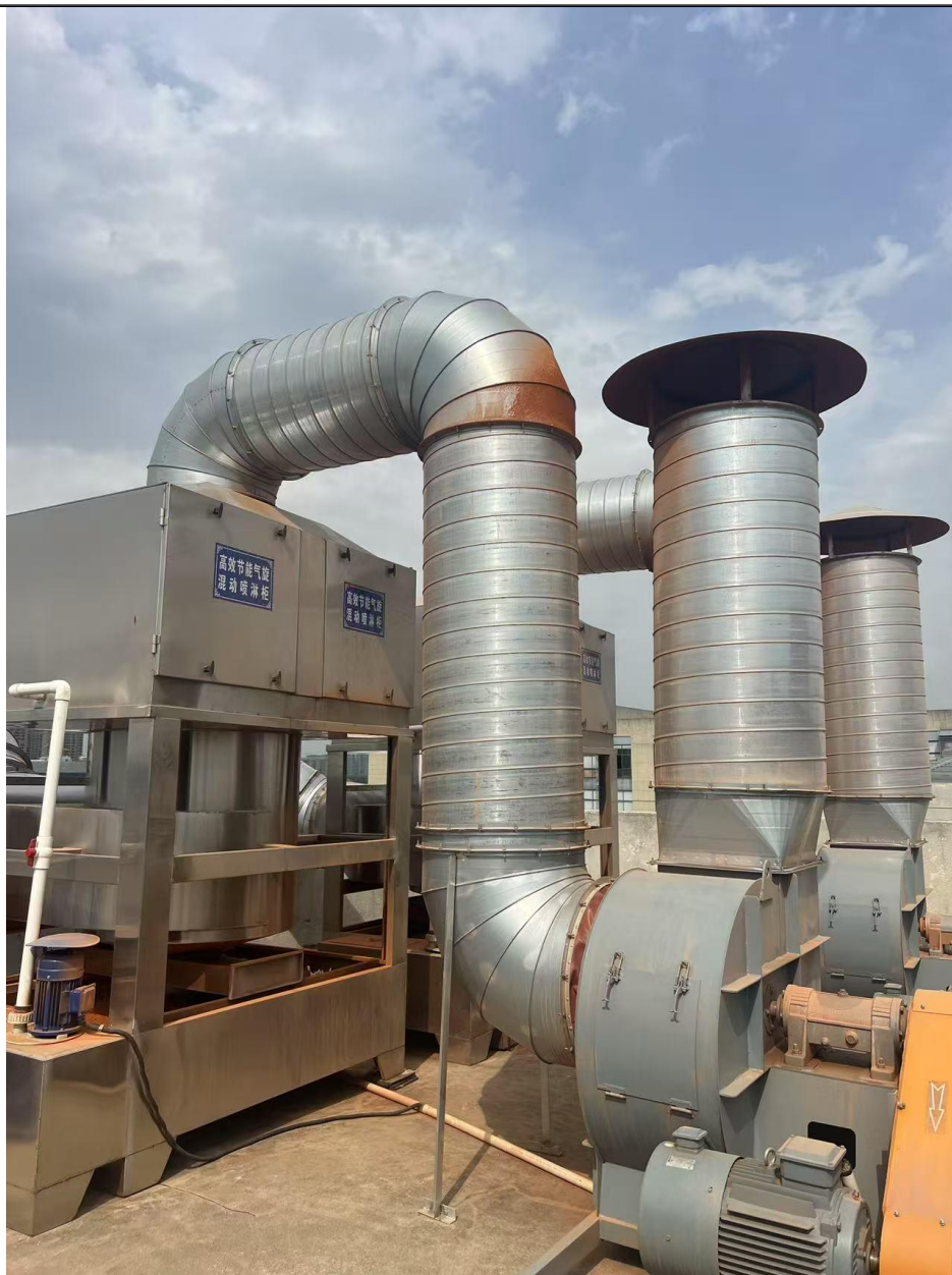
2 个气旋喷淋塔
