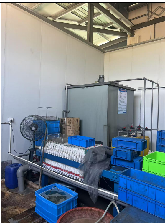
厂区污水处理站
