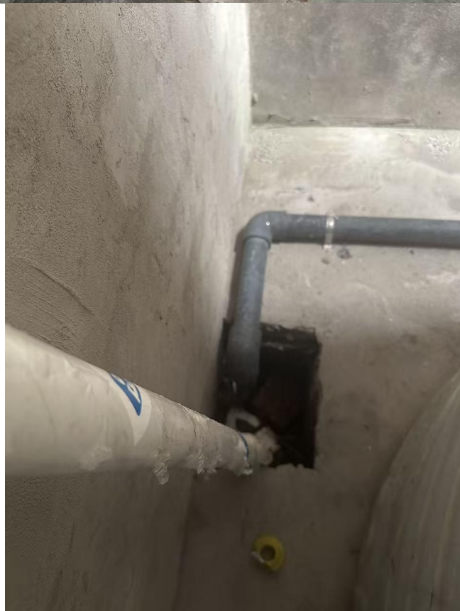
污水处理设施
