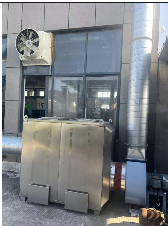
活性炭吸附+25m 高排气筒
