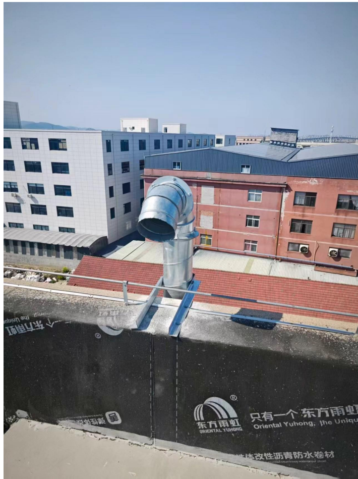
抛丸粉尘 20m 排气筒
