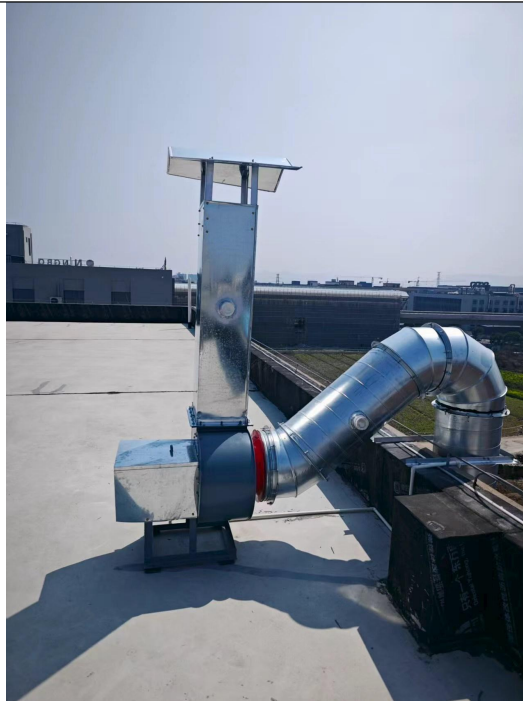
注塑废气 20m 排气筒
