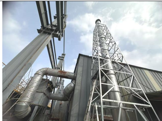
废气处理设施
