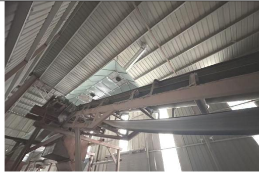
破碎生产线上的废气集气罩
