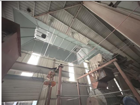
破碎生产线上的废气集气罩
