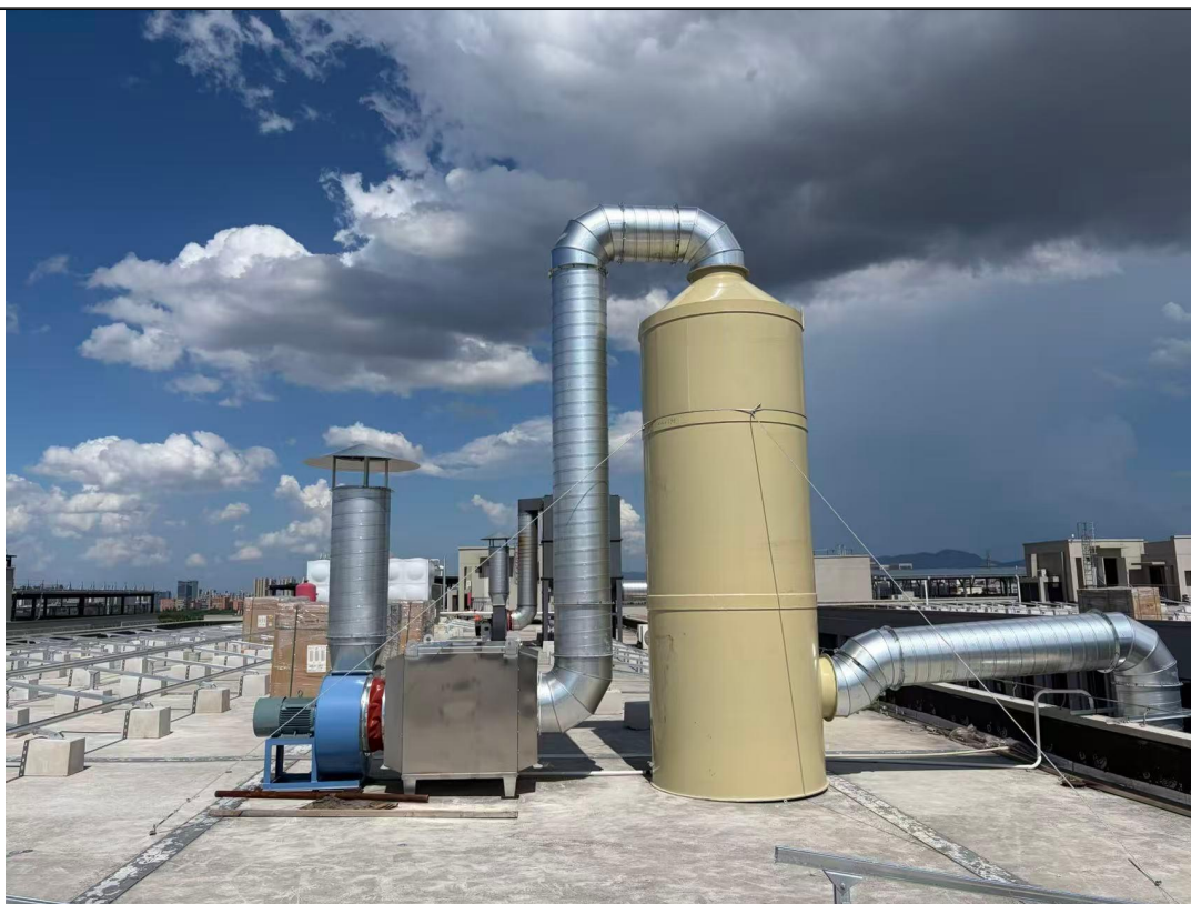
水喷淋+过滤棉+活性炭吸附
