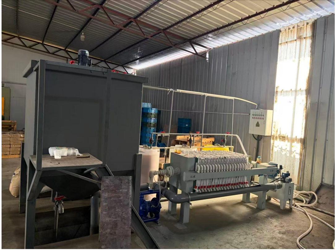
厂区污水处理站
