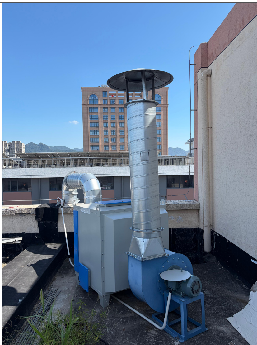
活性炭吸附+25m 高排气筒
