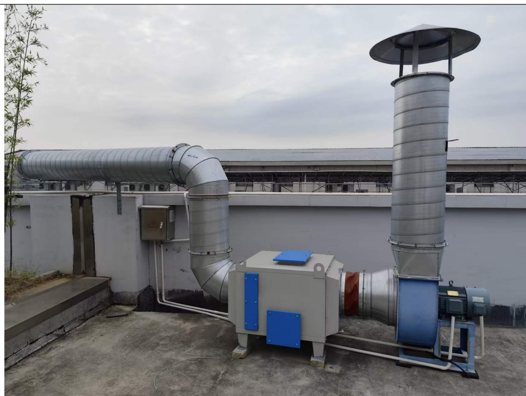
活性炭吸附+25m 高排气筒
