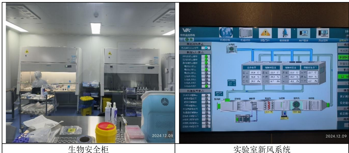
图5-1 废气治理设施
