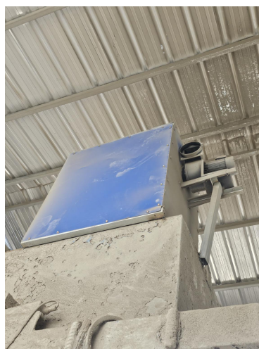
搅拌楼内除尘器
