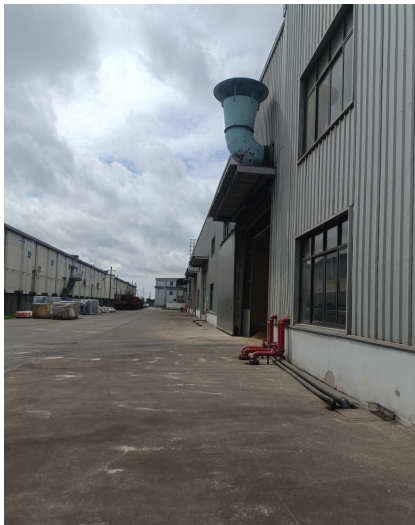
1#排气筒废气排放口
