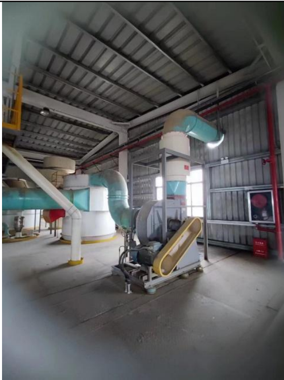
旋风+脉冲布袋除尘器+5#排气筒（一次冷却）
