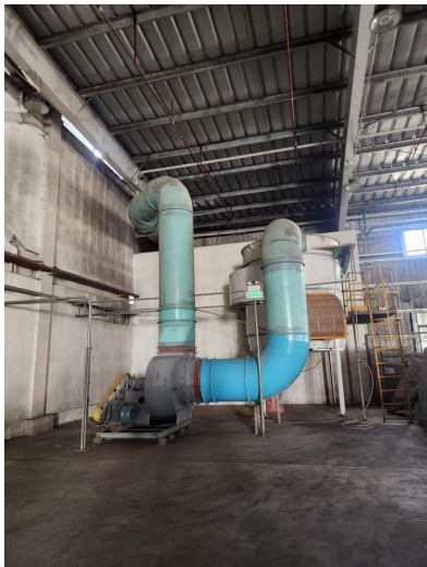
脉冲布袋除尘器+1#排气筒（投料）
