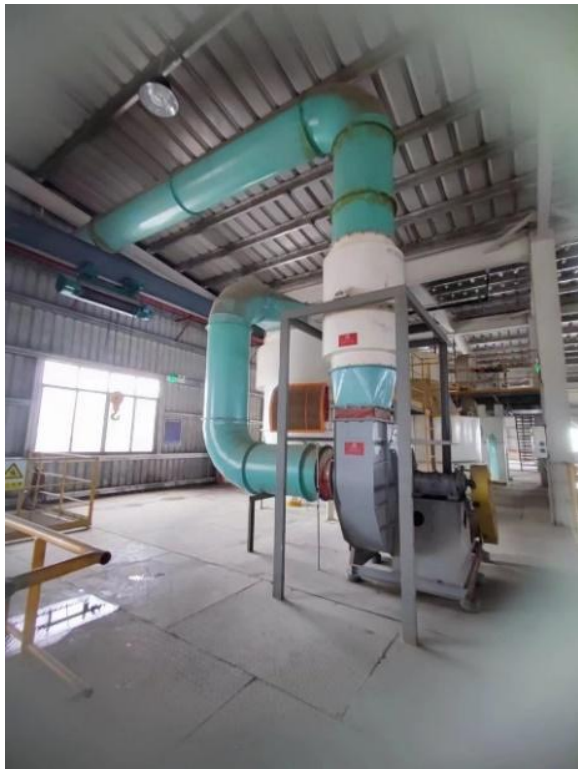
旋风+脉冲布袋除尘器+6#排气筒（二次冷却）
