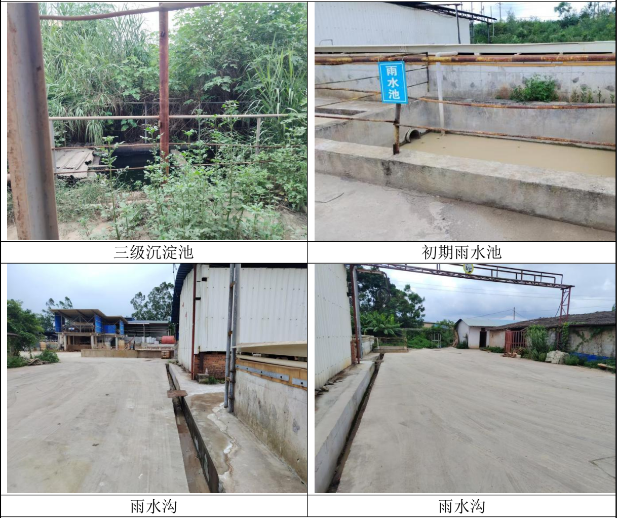
图5-3 项目废水治理设施
