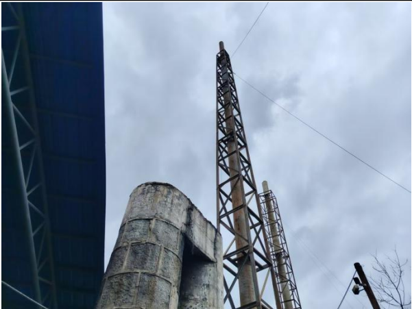
麻石水膜+DA001锅炉烟囱
