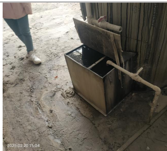
喷淋塔配套水箱
