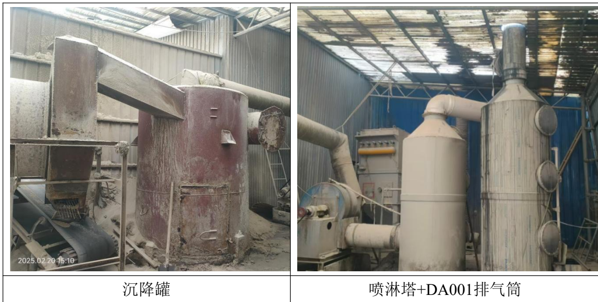
图5-1 废气治理设施
