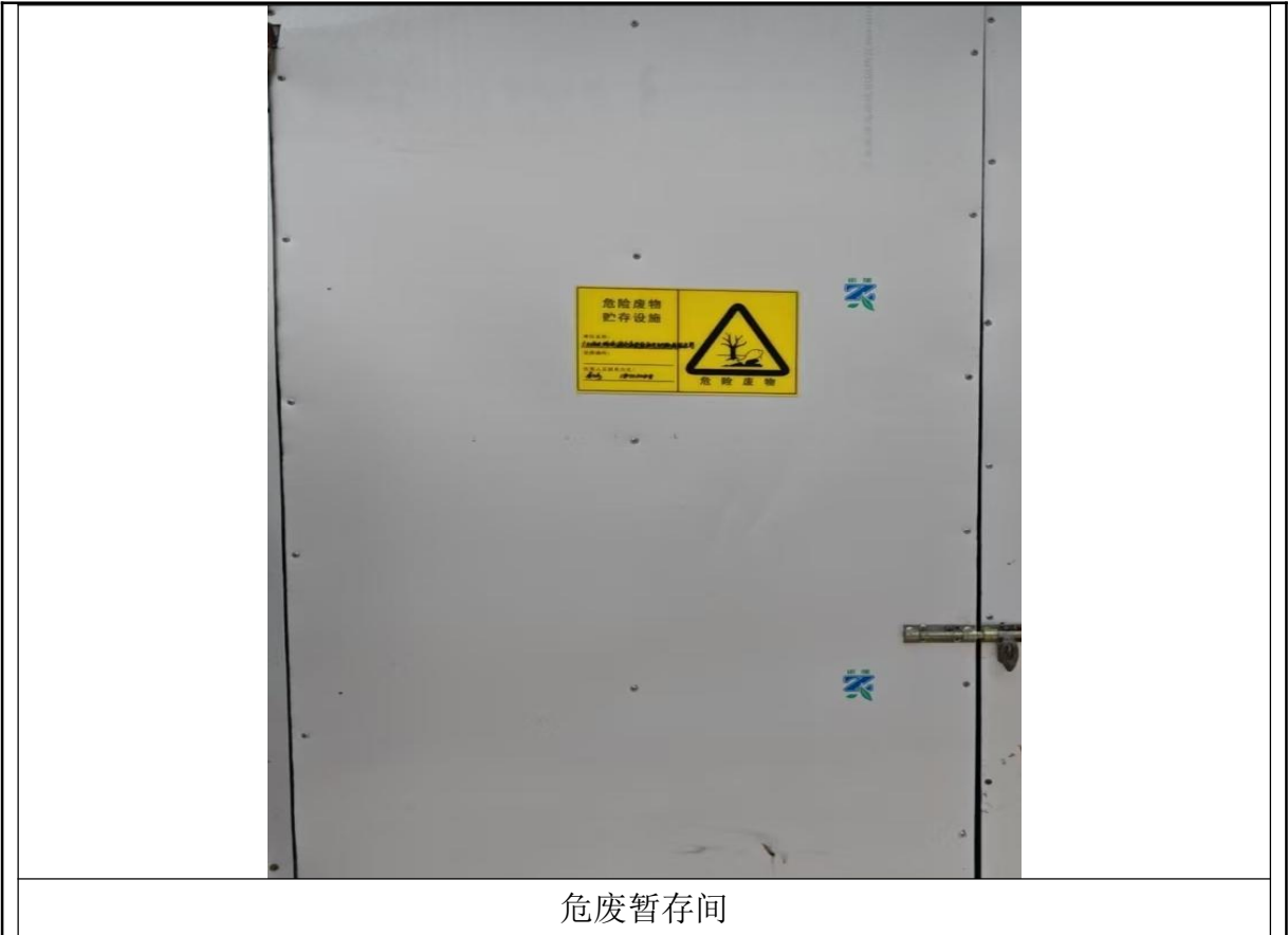
图5-3固体废物污染防治设施
