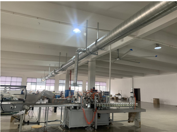
胶水废气收集装置
