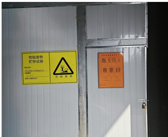
危险废物仓库
