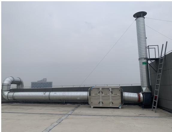
注塑废气活性炭吸附装置
