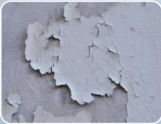
涂层老化开裂，外观严重破损
